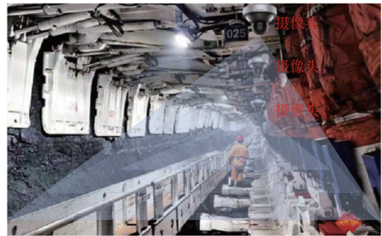
图 6 综采工作面摄像头位置安装
