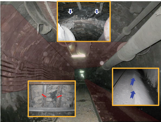
图 3 芦岭煤矿西轨大巷变形破坏现场 [42]
